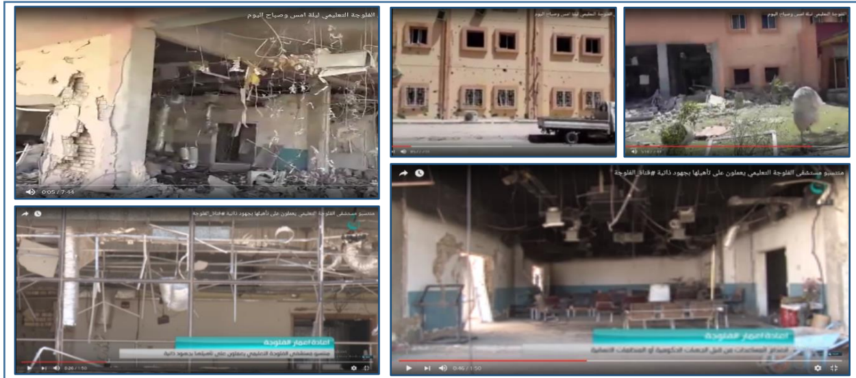
الشكل رقم (11) يوضح الأضرار التي اصابته مبنى مستشفى الفلوجة التعليمي (على مستوى المبنى ككل). (Mohammed, 2014)
